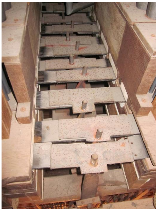
Tussen twee laden zijn de slepen verbonden met ijzeren platen, waarop de registermechaniek aangrijpt. Alles is vrij sterk vervuild en geoxideerd.
